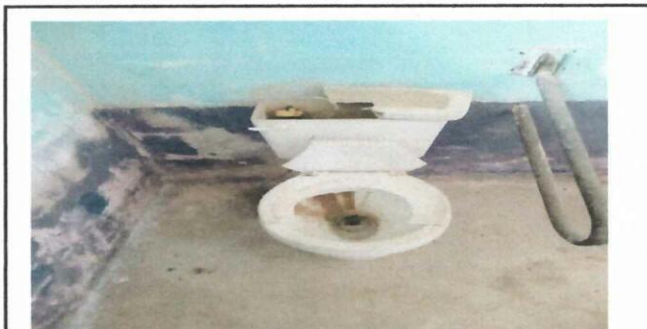
Foto 5: Sanitario que necesita reposicion
