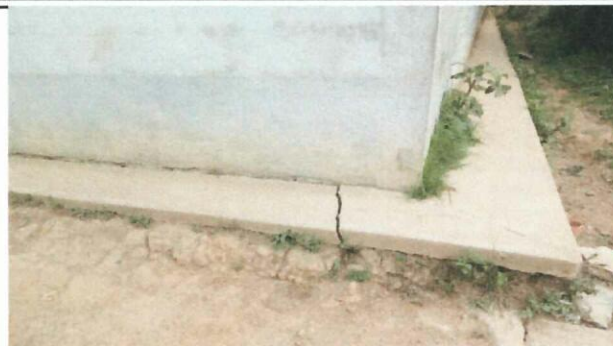
Foto 2: corredor que requiere reparacion
