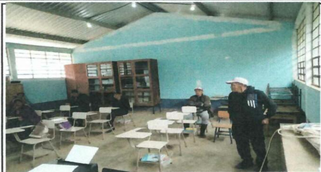
Foto1: Aula 1 que necesita pintarla
