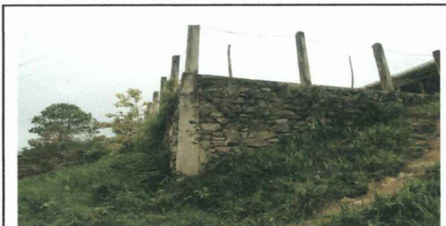
Foto 3: foto de muro de contencion que necista reforzamiento
