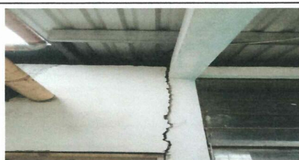
Foto 4: foto de pared que necesita reparacion
